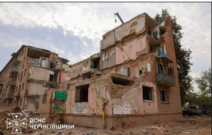
Le bâtiment après la fin de l'opération de recherche et de sauvetage, 8 oct.
