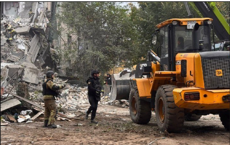
Rescatistas y maquinaria junto al edificio residencial destruido, Zaporiyia
