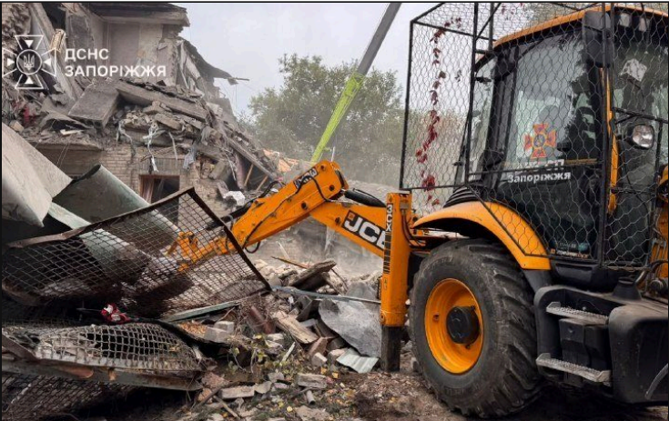
Une pelleteuse dégage la partie effondrée
