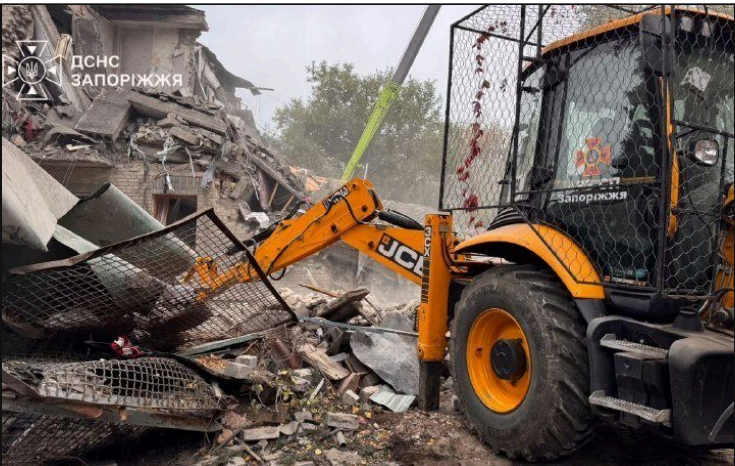
挖掘机清理倒塌部分 乌克兰国家紧急服务局 (DSNS) · 2026-10-10 · CC BY 4.0 https://t.me/dsns_telegram/77176
