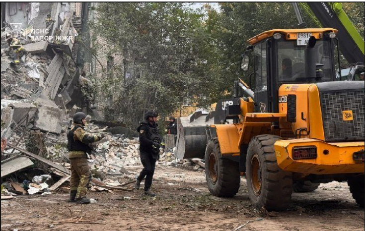
被毁居民楼旁的救援人员和机械，扎波罗热 乌克兰国家紧急服务局 (DSNS) · 2026-10-10 · CC BY 4.0 https://t.me/dsns_telegram/77159
