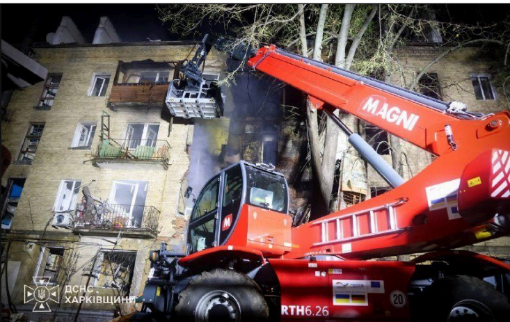
Una grúa junto al edificio dañado
