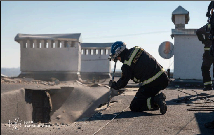
Le trou laissé dans le toit par la frappe
