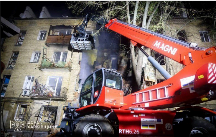
Une grue devant le bâtiment endommagé
