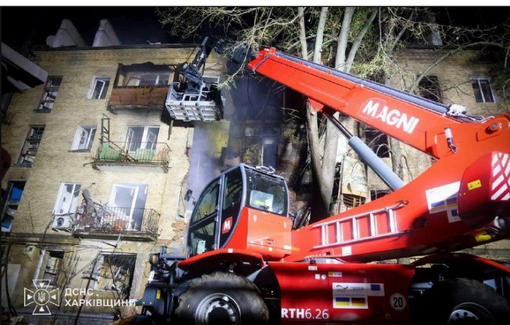
Кран у повреждённого здания
