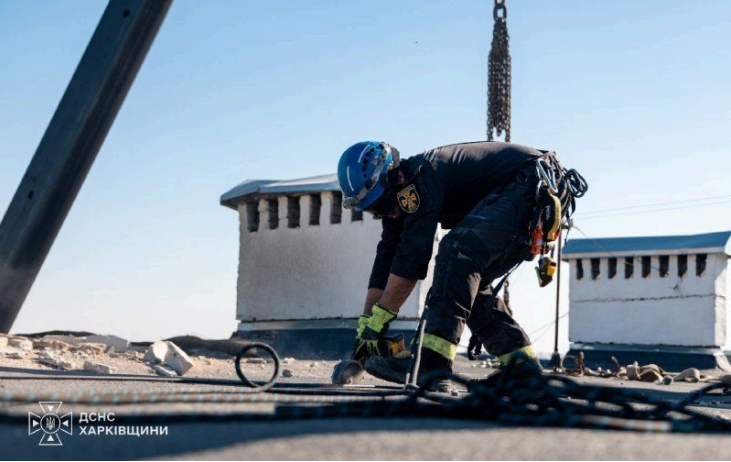
救援攀登队员在受损建筑屋顶作业 乌克兰国家紧急服务局（DSNS） · 2026-10-12 · CC BY 4.0 https://t.me/dsns_telegram/77419
