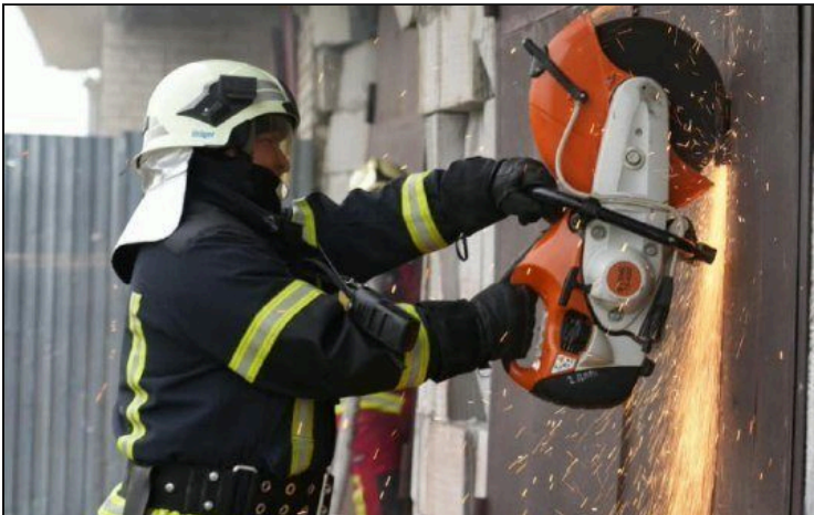
Loutsk, 16 oct. : des pompiers devant une coopérative de garages en feu après l'attaque russe Service d'urgence de l'État d'Ukraine (DSNS) · 2026-10-16 · CC BY 4.0 https://t.me/dsns_telegram/77895
