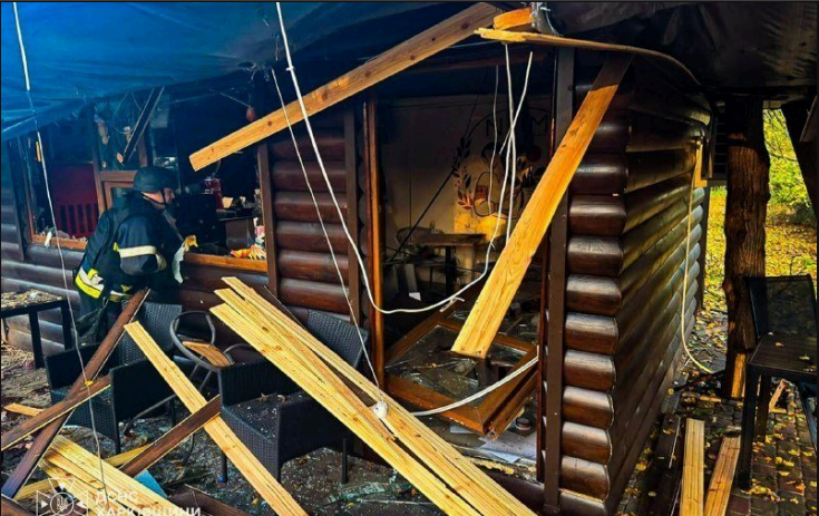
La cafetería dañada en el parque
