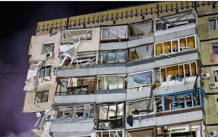
El edificio la tarde del ataque
