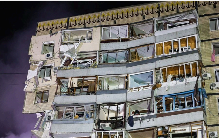
L'immeuble le soir de la frappe
