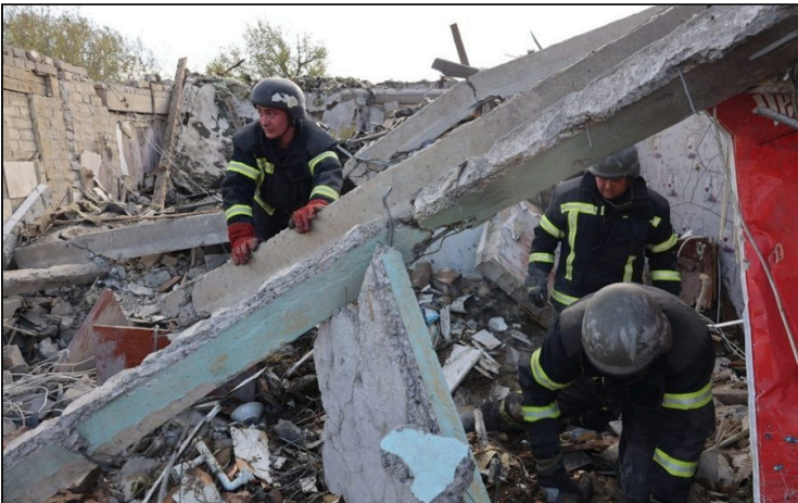
Rescatistas trabajan entre las losas derrumbadas del edificio
