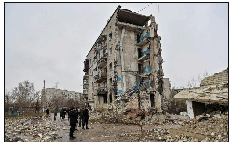
2 شارع بيرشوترافنيفا: الجزء المنهار من المبنى
