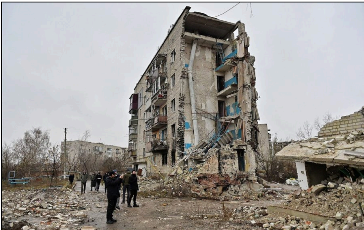
2, rue Pershotravneva : la partie effondrée de l'immeuble
