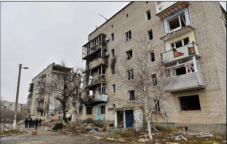
L'immeuble d'habitation du 2, rue Pershotravneva, frappé le 9 mars 2022
