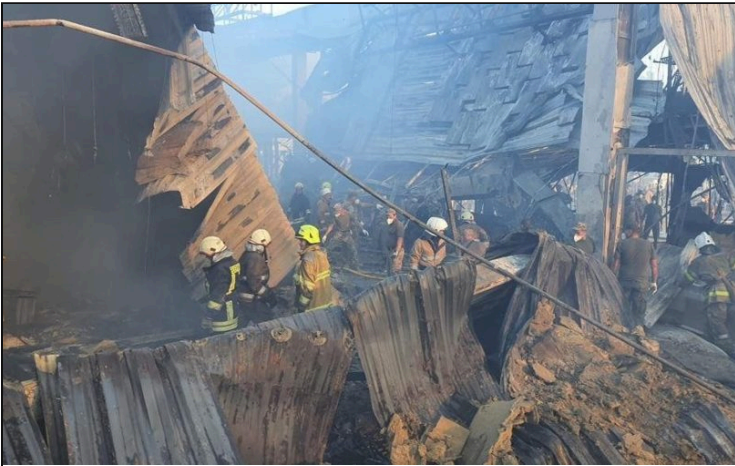
Спасатели в обрушившейся конструкции
