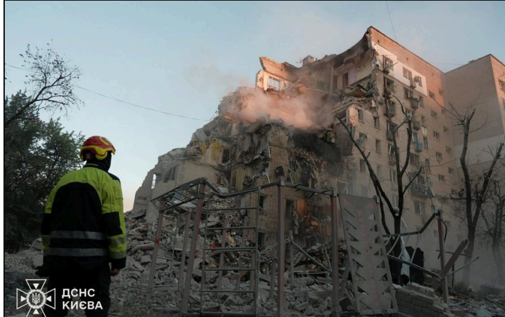
القسم المنهار من المبنى السكني في حي دارينيتسكي
