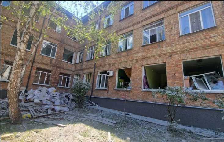
Un edificio escolar dañado esa misma noche
