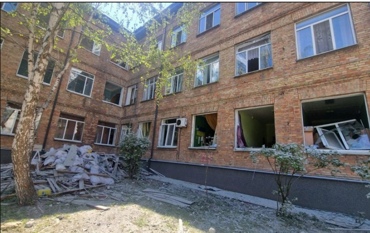
Un bâtiment scolaire endommagé la même nuit
