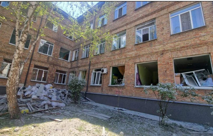
Здание школы, повреждённое той же ночью Kyiv City State Administration · 2026-07-02 · CC BY 4.0 https://commons.wikimedia.org/wiki/File:Destructions_in_Kyiv_after_Russian_attack,_2026-07-02_(50).jpg
