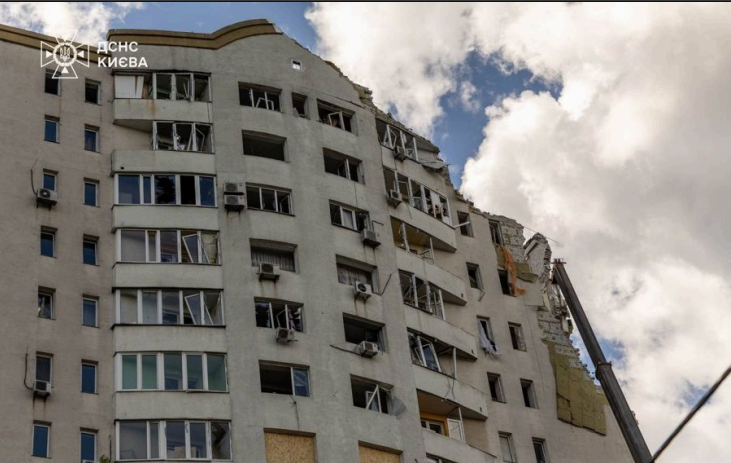
16-этажный дом после окончания спасательных работ ГСЧС Украины · 2026-07-02 · CC BY 4.0 https://commons.wikimedia.org/wiki/File:Destructions_in_Kyiv_after_Russian_attack,_2026-07-02_(40).jpg
