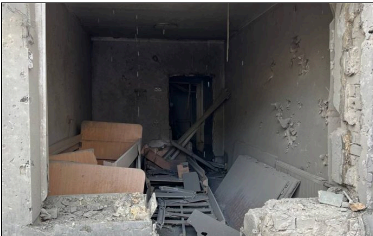
Un service endommagé de l'hôpital
