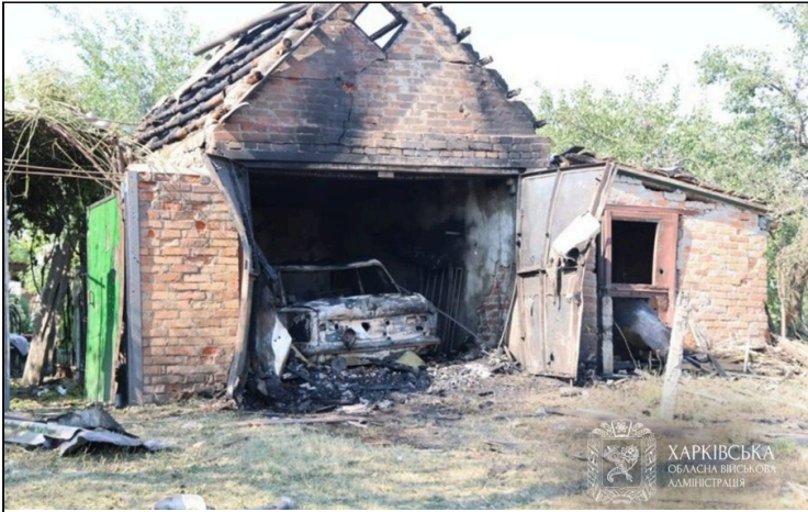
Le centre de Petchenihy après la frappe de missiles du 18 août 2026 — publication de l'administration régionale, image 4 sur 6
