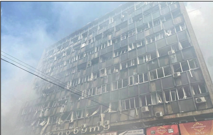
L'immeuble de bureaux en face, aux fenêtres soufflées
