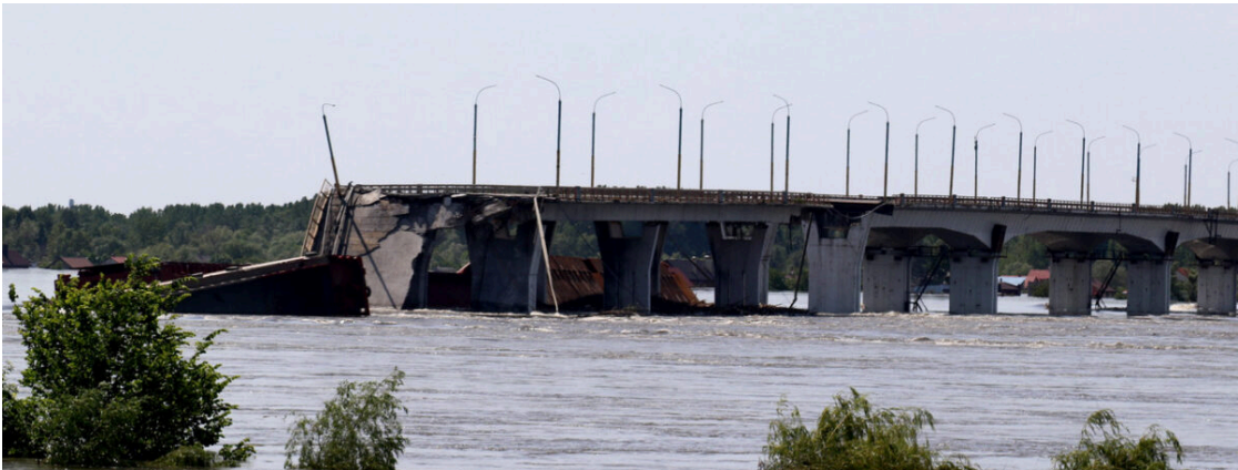
2023年6月7日：卡霍夫卡大坝被炸毁后，被毁的安东诺夫卡大桥——从赫尔松通往奥列什基的道路——横跨在洪水之上。照片：Dmytro Zavtonov / ArmiyaInform，维基共享资源，CC BY 4.0。
