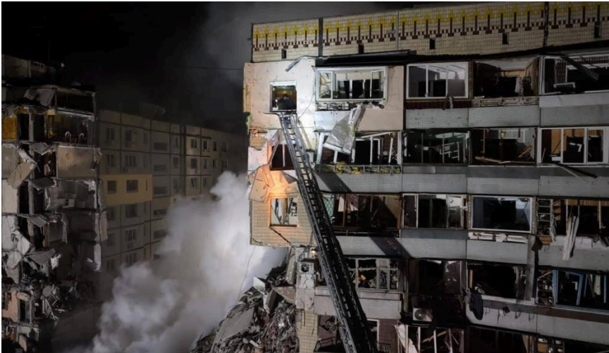
Rescatistas de noche en el portal derrumbado. Foto: Servicio Estatal de Emergencias de Ucrania · CC BY 4.0 · vía Wikimedia Commons
